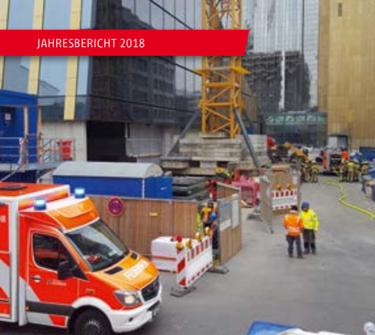
Brand auf einer Großbaustelle in Mitte Bild: Berliner Feuerwehr
